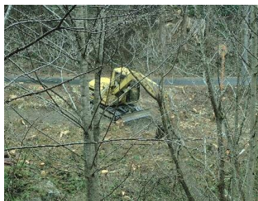
一変した公道側の斜面
